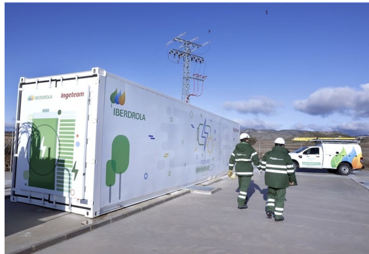
ムルシア（スペイン）の電力貯蔵システム
