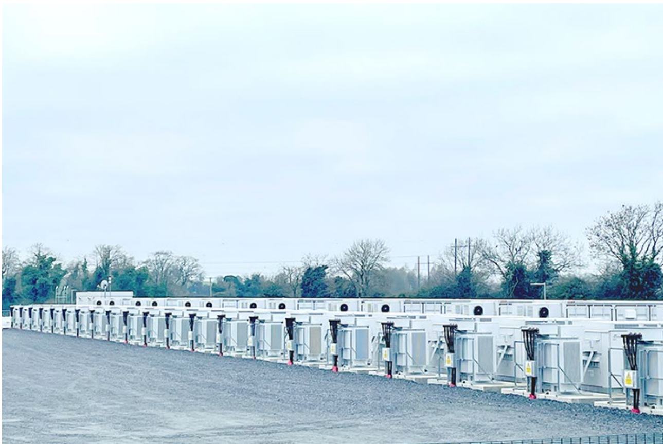
アイルランドのゴーマンにある、容量25 MWh、出力50 MWの設備
